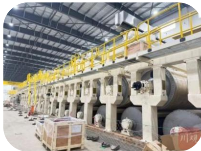
烘缸设备已经安装完毕代玉巍摄
